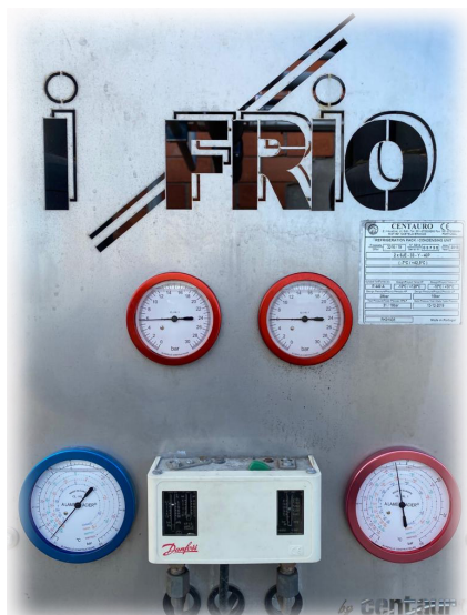
PANEL DE MANÓMETROS
